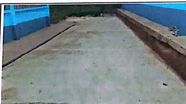
Foto 5: Sustrucción de piso en torta de concreto.
